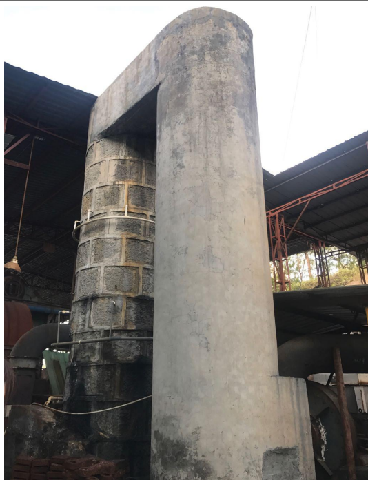
麻石除尘设施
