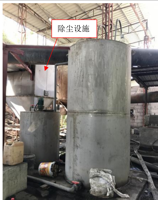
尿素溶解罐及除尘设施
