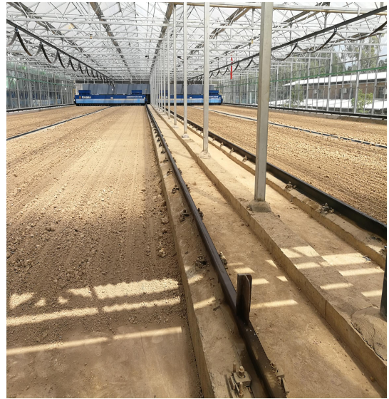
互通式干燥温室（2条污泥干化线）
