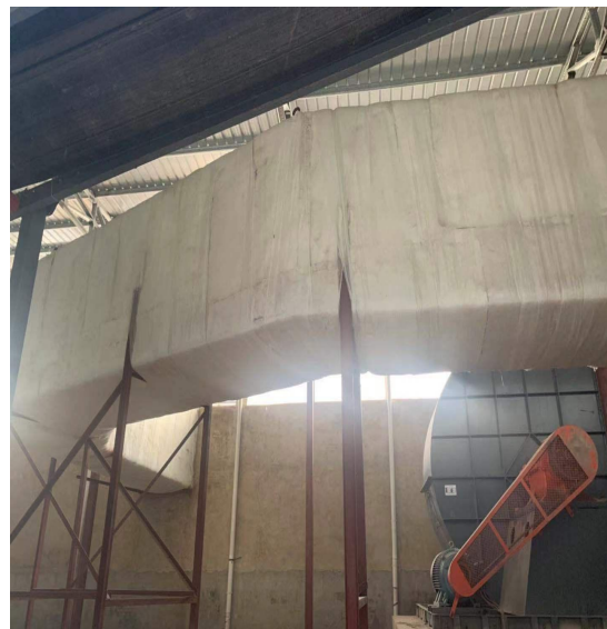
隧道窑烟气引回管道
