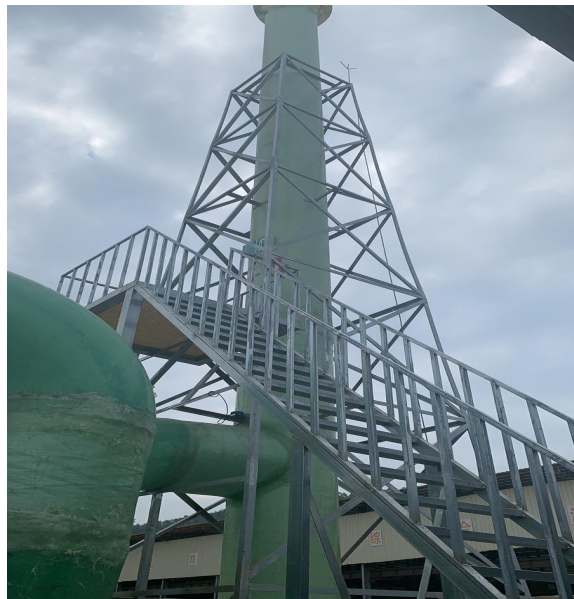
生物除臭装置排放口
