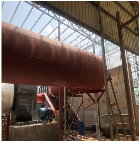
隧道窑烟气余热利用管道
